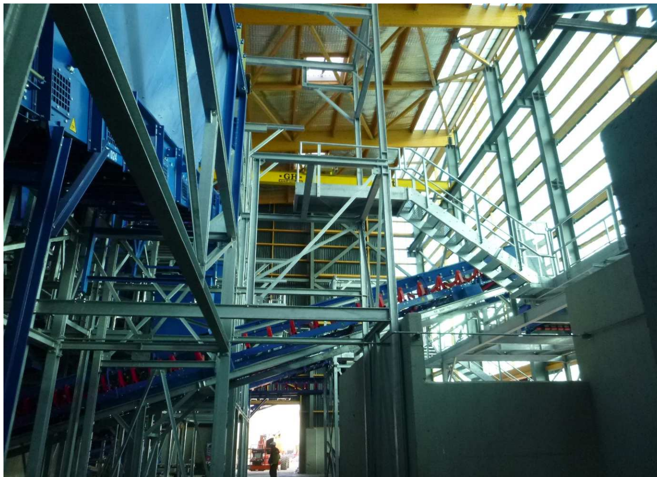
Intérieur du bâtiment de tri secondaire – Equipements de tri secondaire installés (photo d'octobre 2015)
