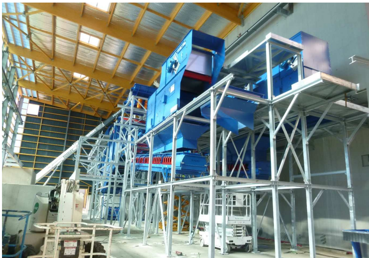
Intérieur du bâtiment de tri secondaire – Installation des équipements de tri secondaire (photo de septembre 2015)
