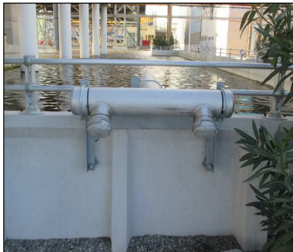
Prises d'eau pompiers supplémentaires dans Grand bassin et Canal de lagunage
