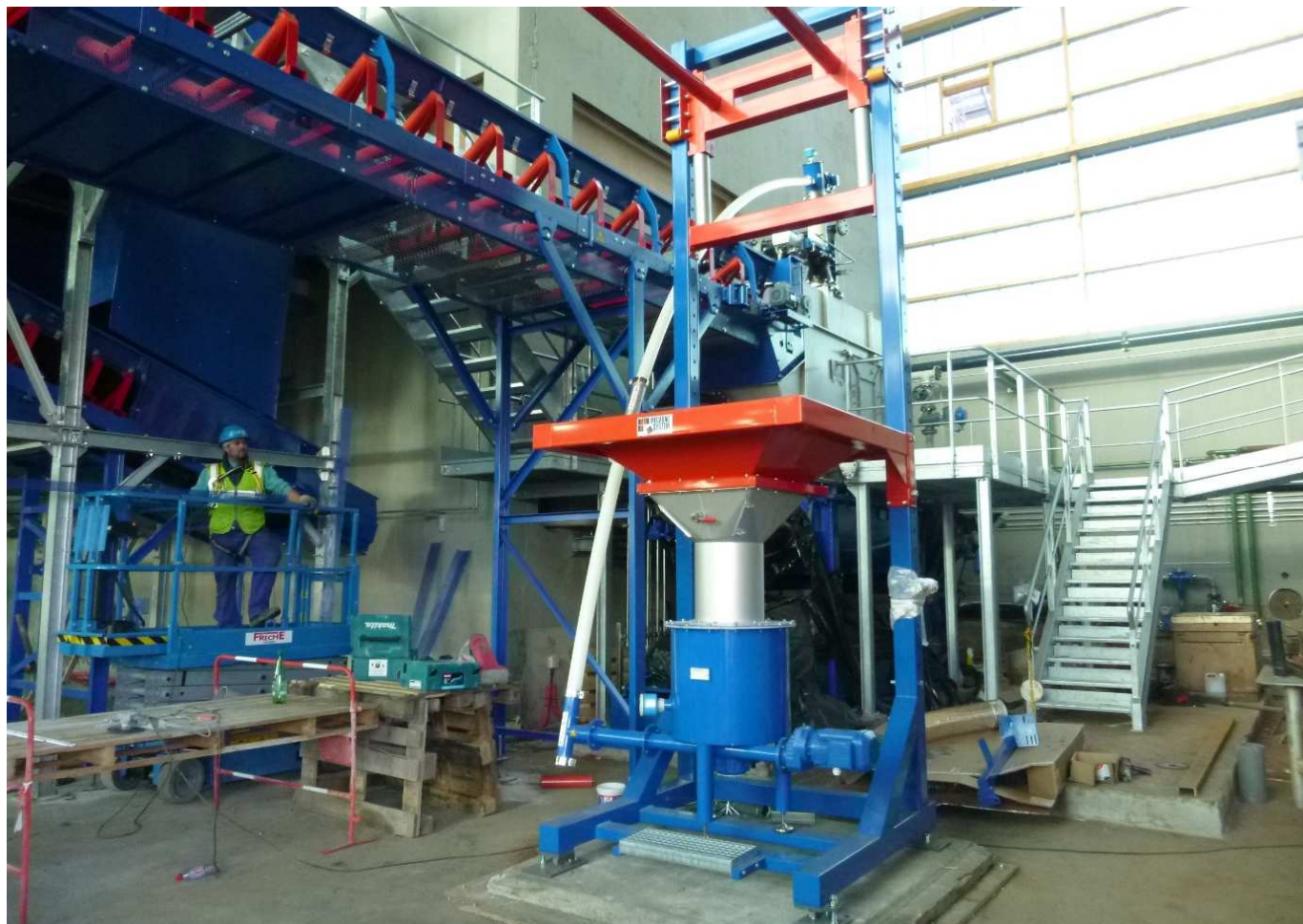
Intérieur du bâtiment de tri secondaire - Partie « Introduction de la matière organique dans les digesteurs » (photo d'octobre 2015)
